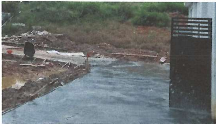
LOKASI AREA RUMAH GENSET
